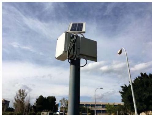
Figura 189. Panel solar, antena de radio y nodo de control para cuatro contadores de agua. [11]
