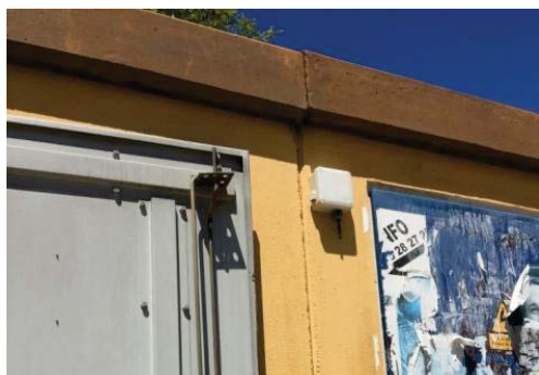
Figura 191. Nodo radio para envío de lecturas de electricidad en centro de transformación. 4 edificios [11]
